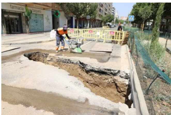
La calzada de Riu Ebre aún tenía ayer un gran zanja entre Doctora Castells y Doctor Zammenhoff. - MAGDALENA ALTISENT
